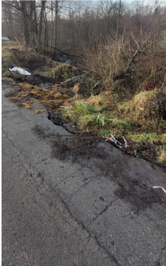
Fot.2 Uszkodzenia drogi powiatowej 1413S
