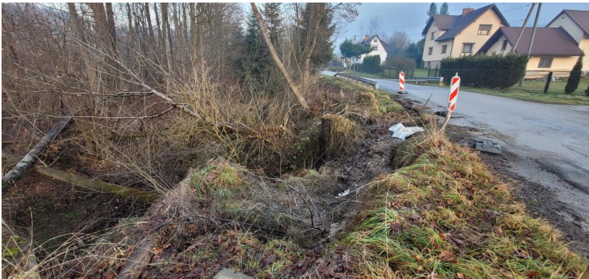
Fot.1 Widok na powstałe osuwisko
