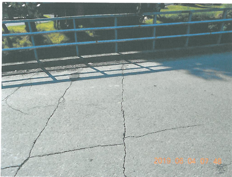
Zdj. 4 Pomost – pęknięcia nawierzchni asfaltowej w miejscach łączenia płyt.
