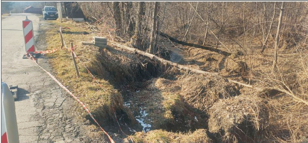
Uszkodzenia jezdni i korpusu w zachodniej części osuwiska
