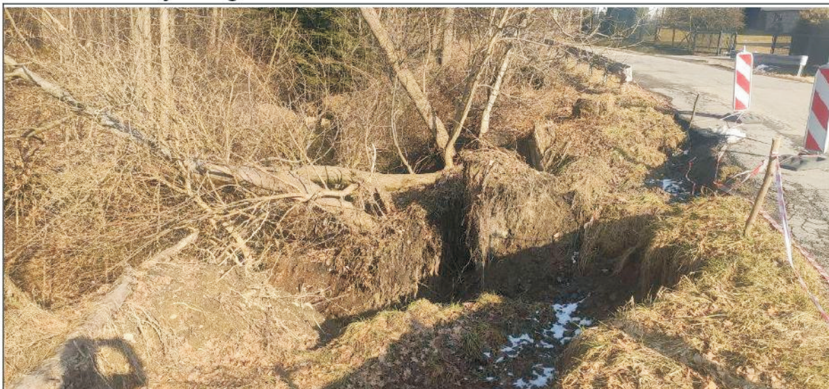
Zniszczona skarpa i korpus drogi pow. wschodnia część osuwiska
