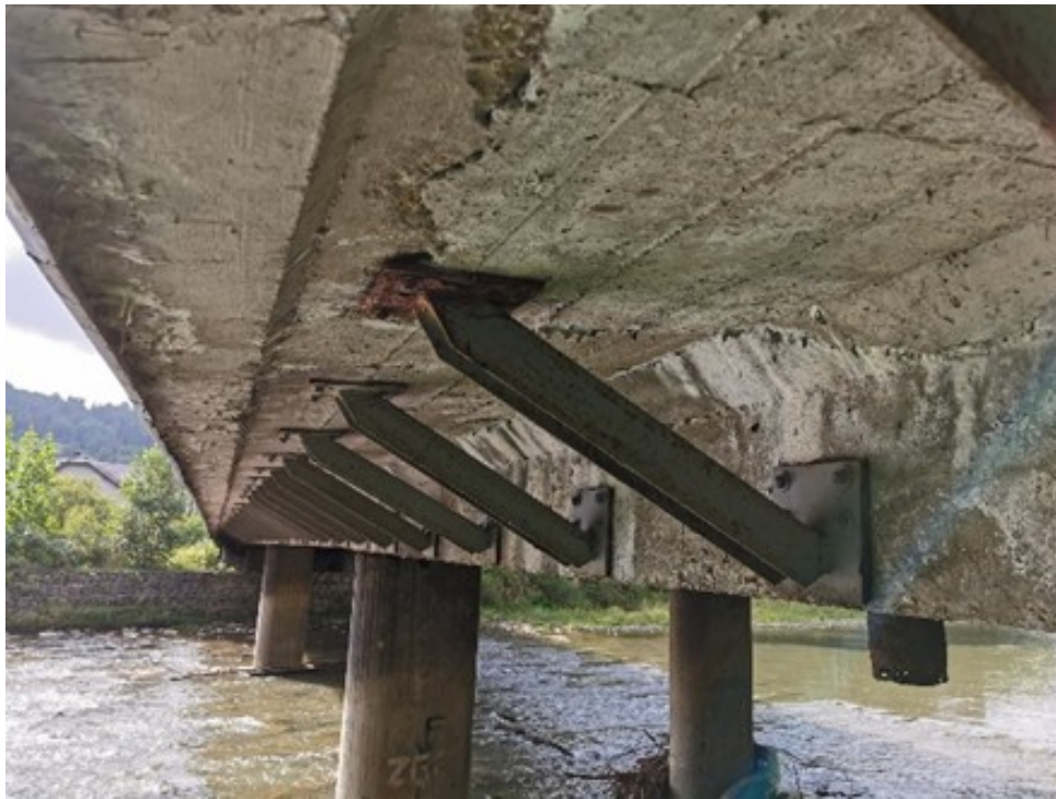
Ilustracja 1: Obiekt mostowy w ciągu DP 1481S dojazd do stacji PKP w km 0+081 w Rajczy - strona wymagająca prac
