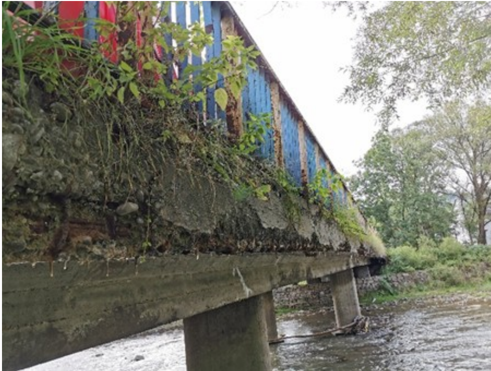
Ilustracja 2: Obiekt mostowy w ciągu DP 1481S dojazd do stacji PKP w km 0+081 w Rajczy - strona wymagająca prac
