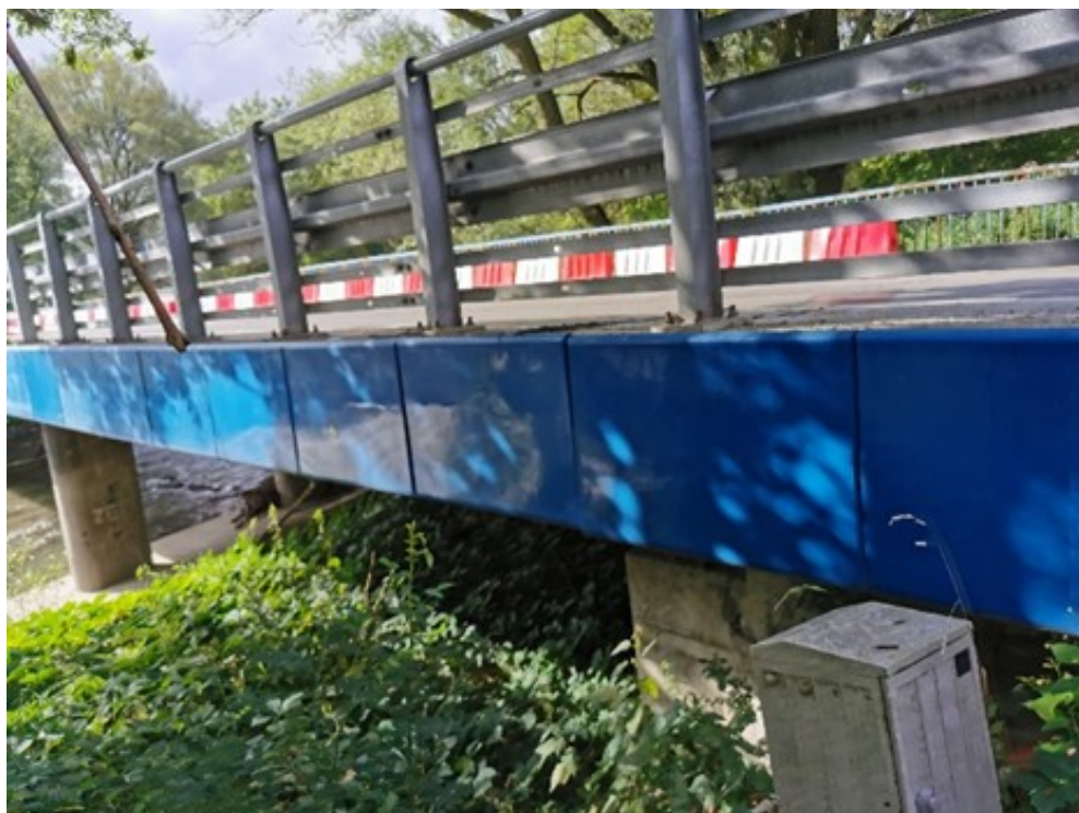
Ilustracja 4: Obiekt mostowy w ciągu DP 1481S dojazd do stacji PKP w km 0+081 w Rajczy - strona na której zostały wykonane prace
