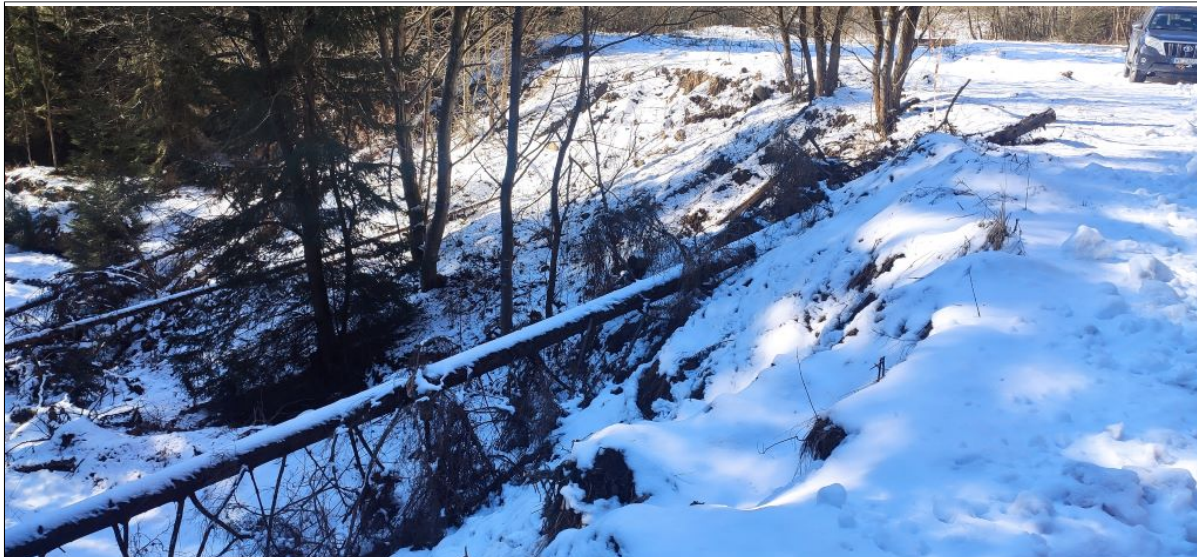
Zachodnia część osuwiska
