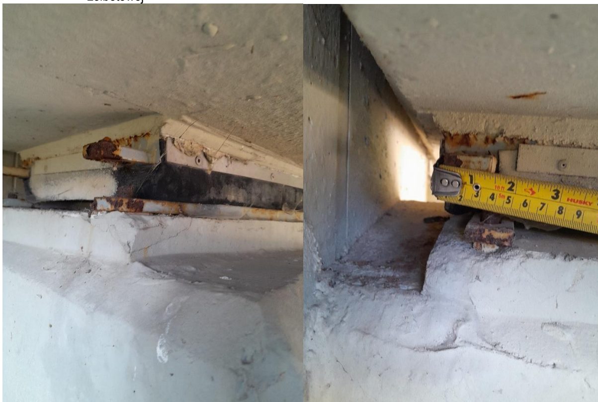
fot. 47. Przyciółek w osi G, łożysko zewnętrzne skrajne – korozja blach łożysk, zniszczenie podlewki żelbetowej
