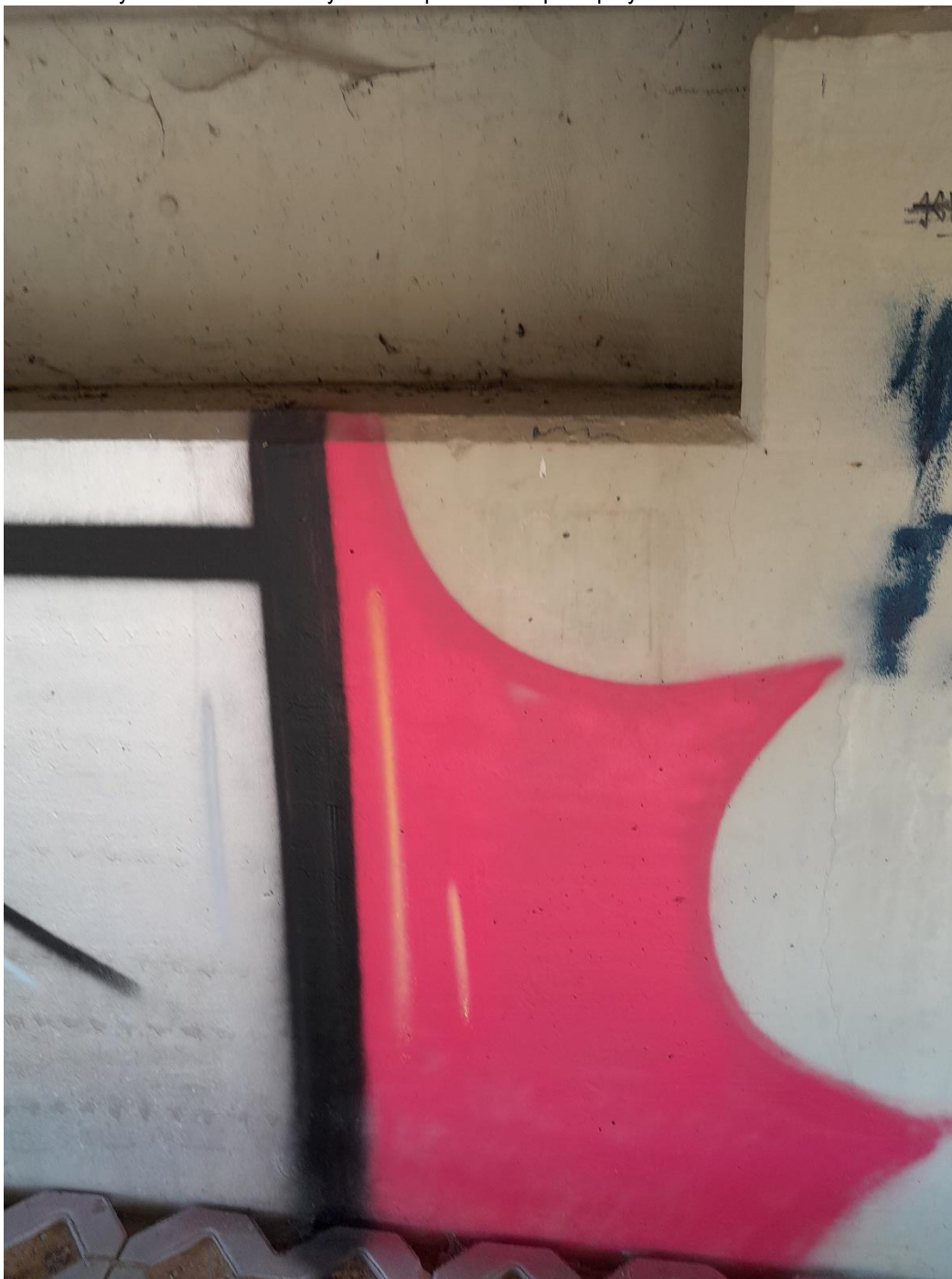
fot. 26. Przyciółek w osi G – zarysowanie pionowe korpusu przyciółka- 1
