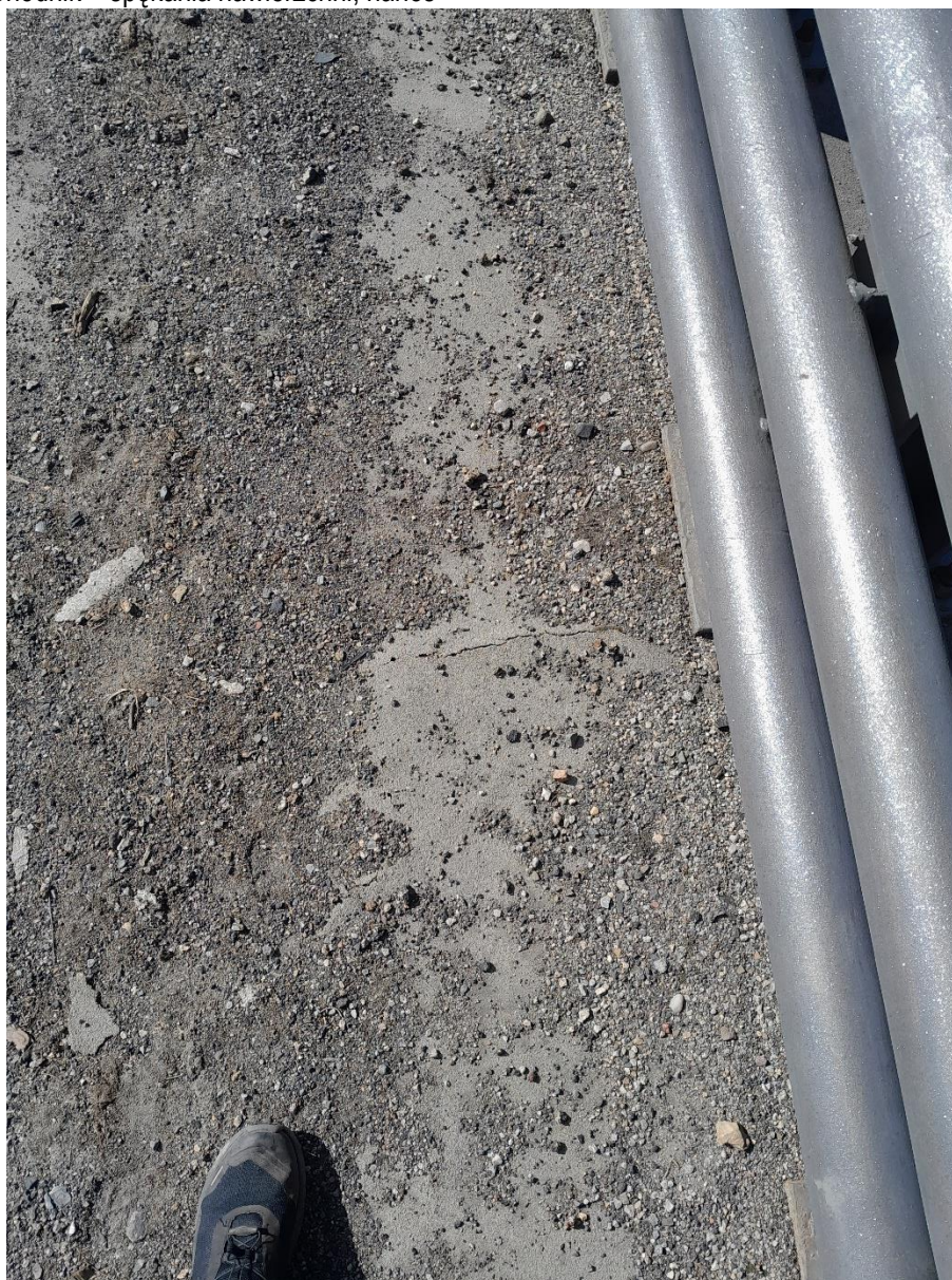
fot. 55. Chodnik – spękania nawierzchni, nanos
