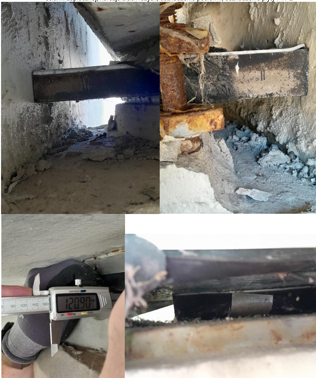
fot. 37. Przyczółek w osi A, łożysko zewnętrzne skrajne– Wysunięcie bloków elastomerowych w stronę ścianki zapleczej, korozja blach łożysk, uszkodzenie podlewki, uszkodzenie płyty PTFE
