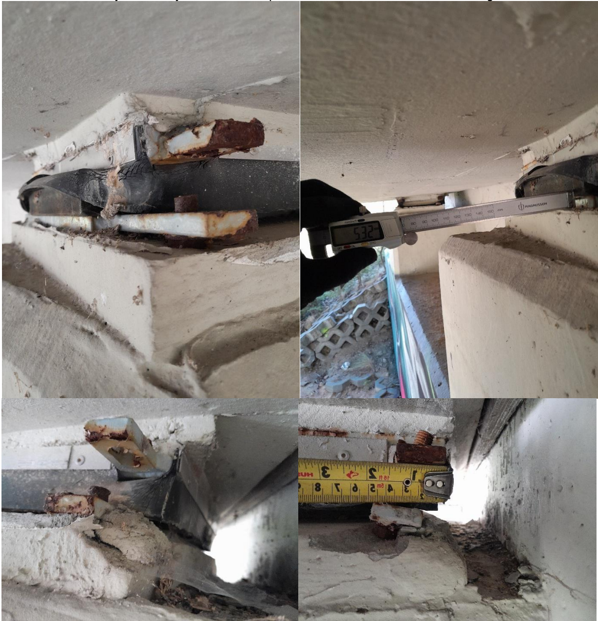
fot. 46. Przyczółek w osi G, łożysko zewnętrzne przedskrajne– Wysunięcie bloków elastomerowych, korozja blach łożysk, uszkodzenie podlewki, uszkodzenie fartucha ochronnego
