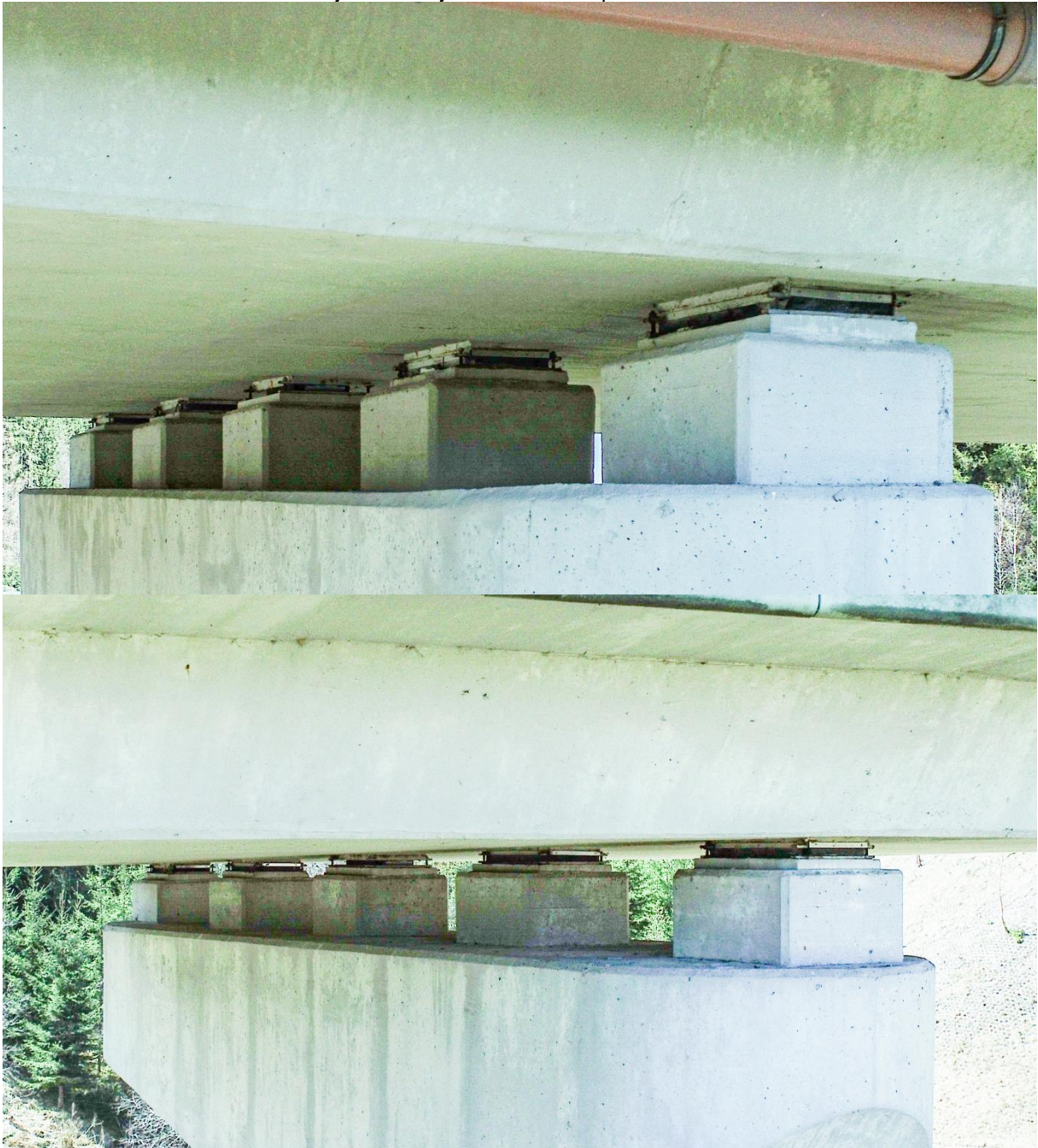
fot. 40. Filar w osi D – korozja blach łożysk, uszkodzenie podlewki
