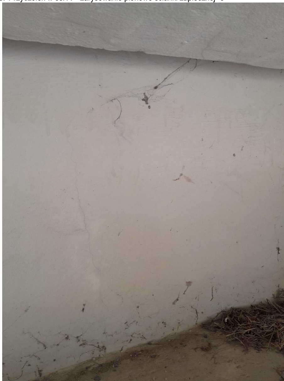
fot. 23. Przyciótek w osi A – zarysowanie pionowe ścianki zapleczej- 3
