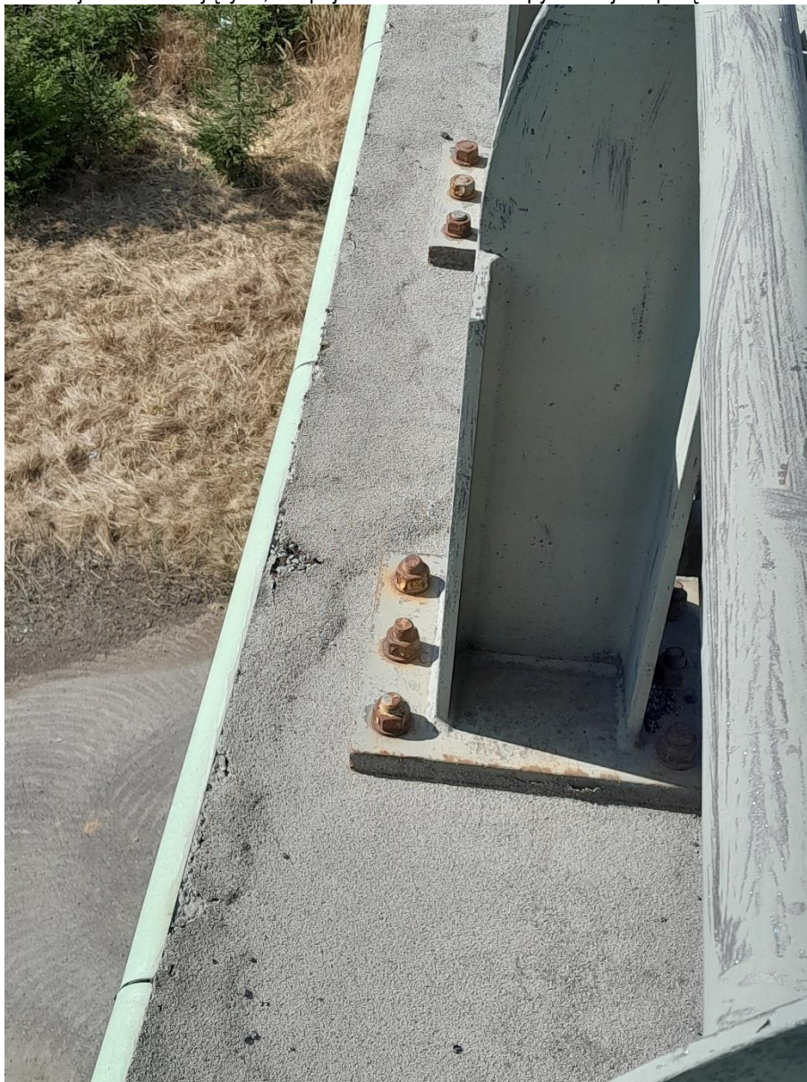
fot. 60. Korozja śrub mocujących, odspojenie nawierzchni kapy w miejscu połączenia z deską gzymsową
