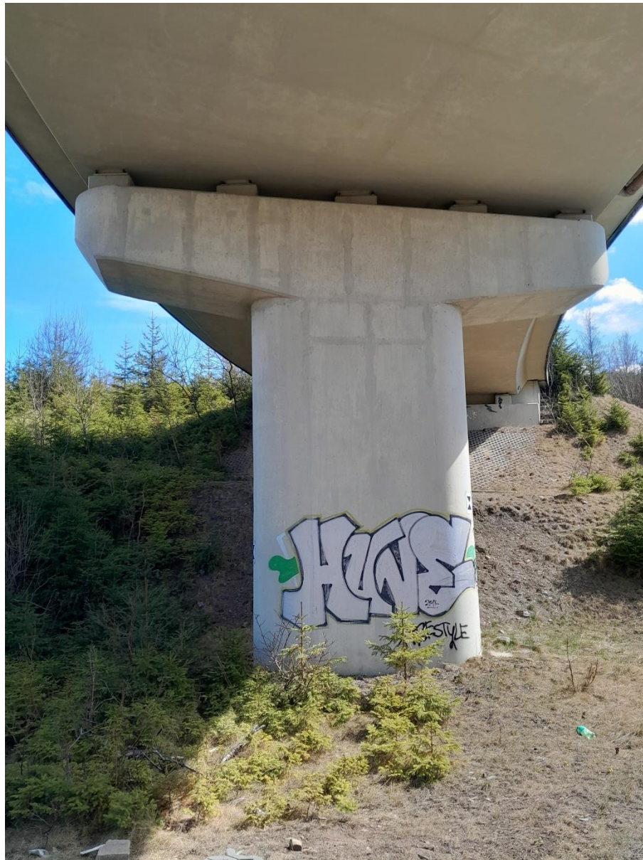
fot. 17. Widok filara w osi F od strony miejscowości Myto. Zanieczyszczenie filara graffiti.
