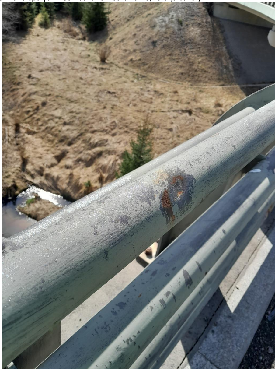
fot. 59. Barieropęcz – Uszkodzenie mechaniczne, korozja bariery
