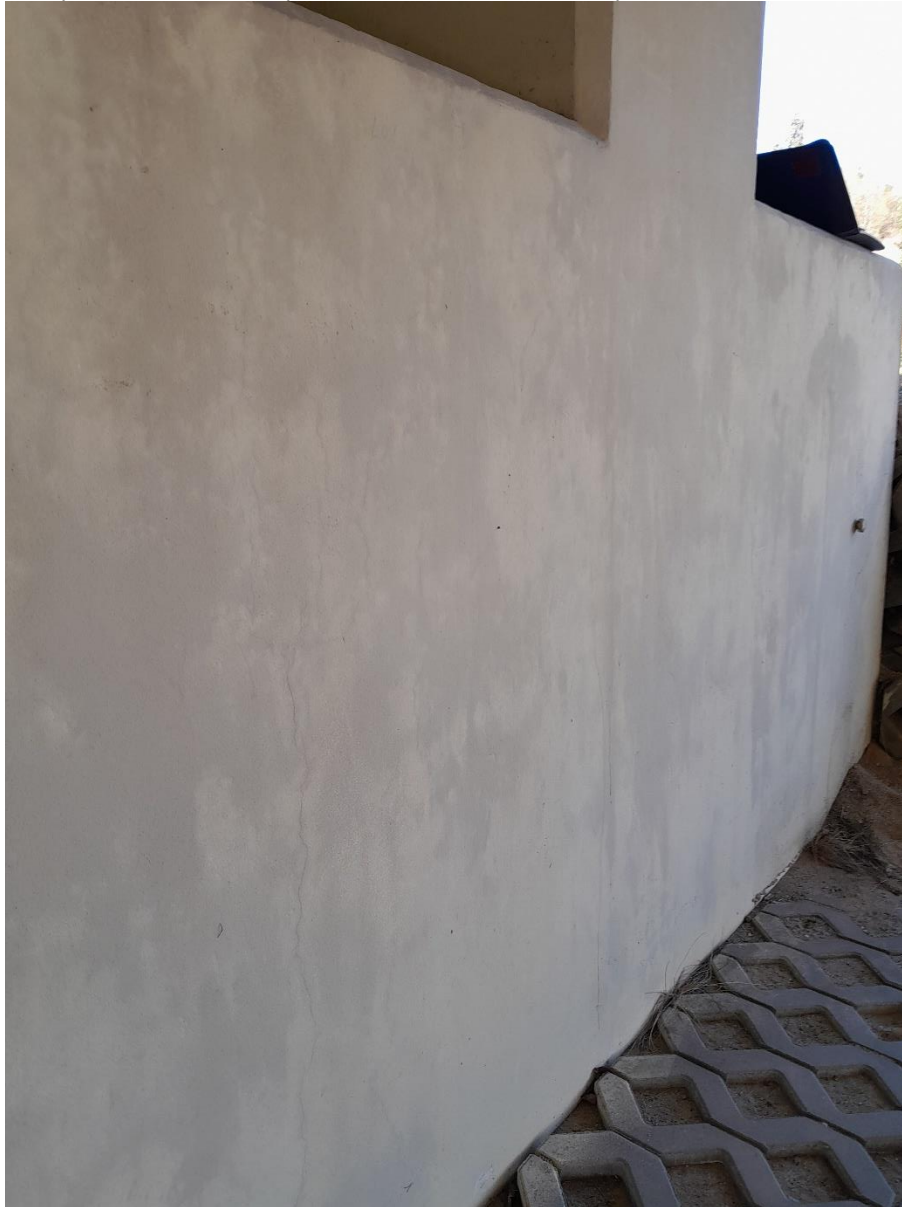
fot. 22. Przyczółek w osi A – zarysowanie pionowe korpusu przyczółka- 2
