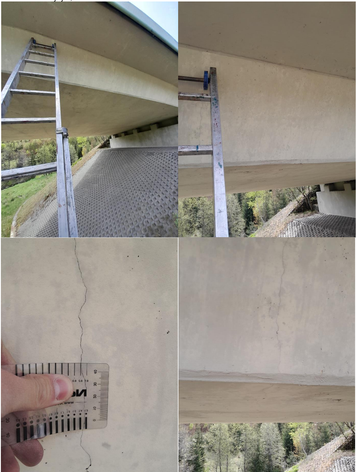
fot. 19. Zarysowanie płyty pomostu na przęśle A-B – widok od strony dolnej wody. Pomiar rozwartości rysy 0,2mm.
