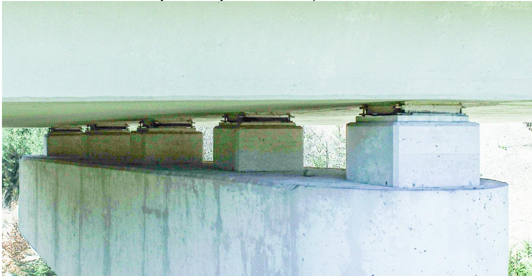
fot. 42. Filar w osi F – korozja blach łożysk, uszkodzenie podlewki
