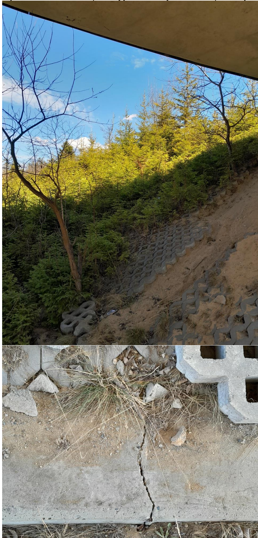
fot. 25. Przyczółek w osi G – stożek porośnięty roślinnością, uszkodzenie podwaliny umocnienia stożka
