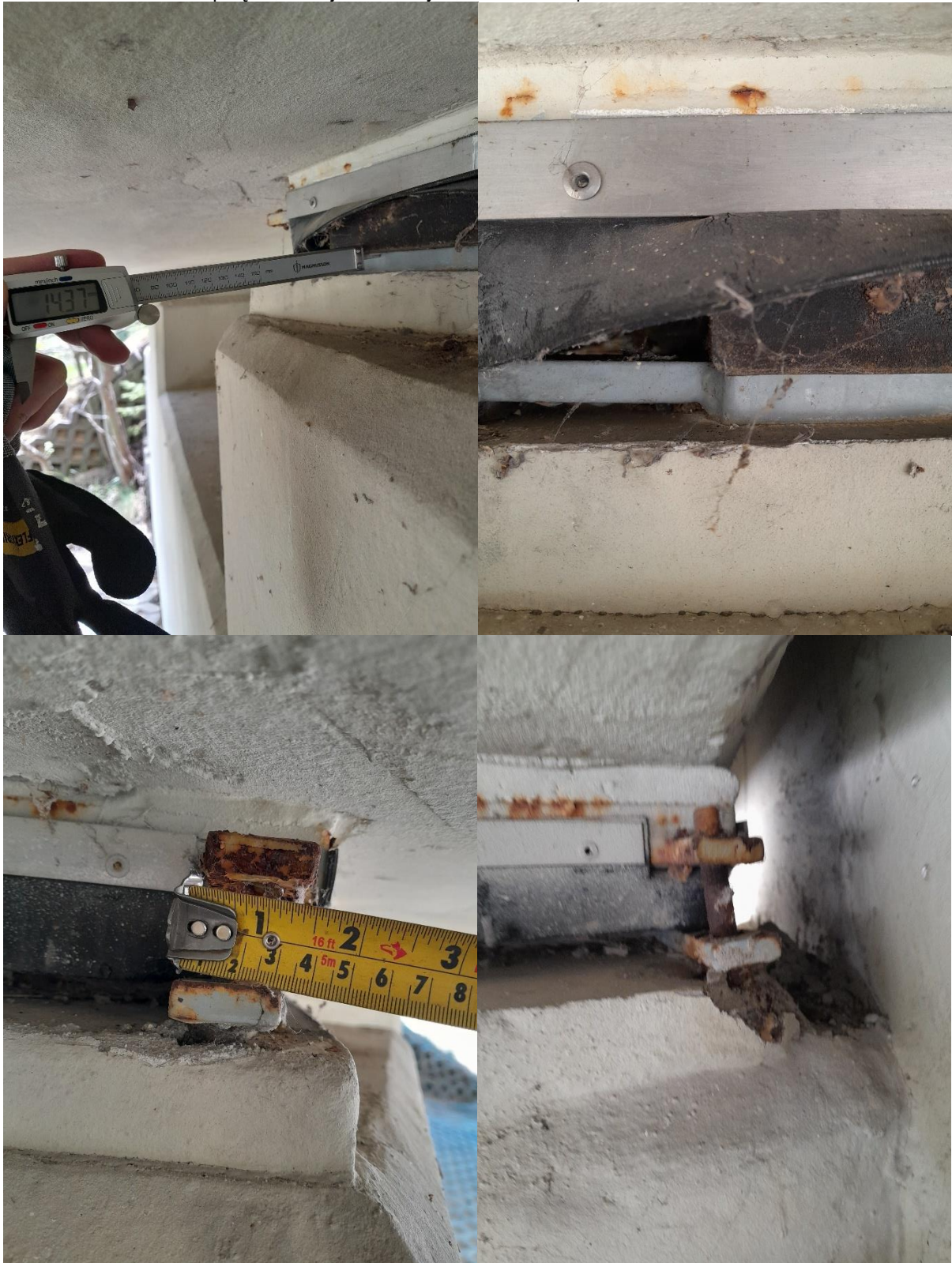
fot. 34. Przyczółek w osi A, łożysko przed skrajne wewnętrzne– Wysunięcie bloków elastomerowych w kierunku przęsła, korozja blach łożysk, uszkodzenie podlewki
