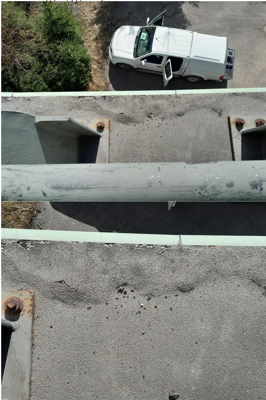
fot. 54. Chodnik – Odspojenie nawierzchni kapy chodnikowej przy desce gzymsowej, korozja śrub mocujących i płyty podstawy
