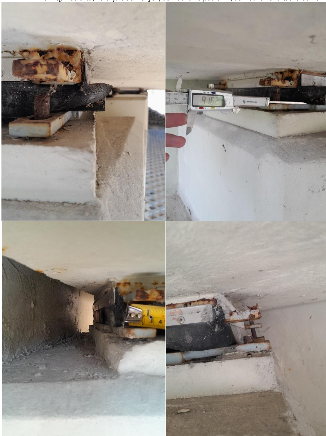
fot. 33. Przyczółek w osi A, łożysko wewnętrzne skrajne– Wysunięcie bloków elastomerowych na zewnątrz obiektu, korozja blach łożysk, uszkodzenie podlewki, uszkodzenie fartucha ochronnego,
