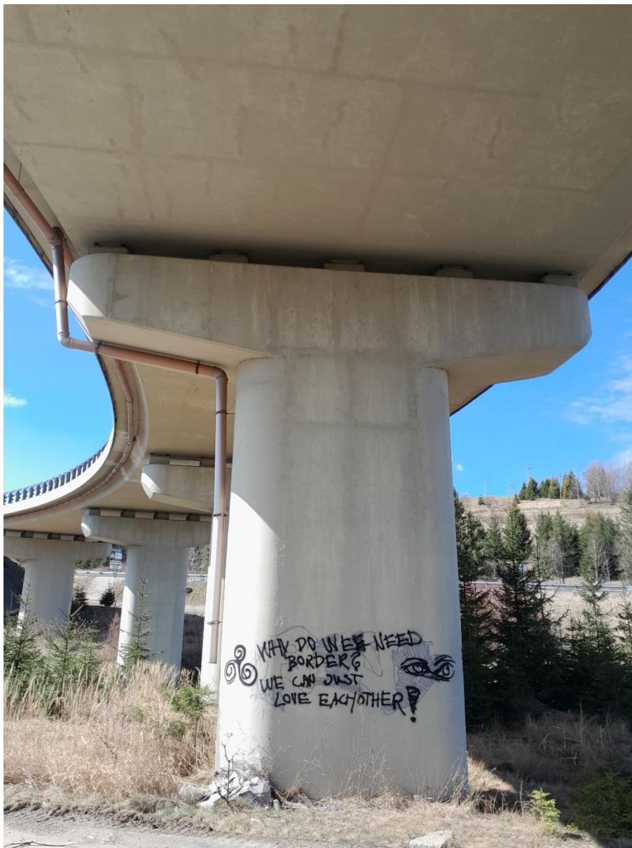
fot. 16. Widok filara w osi E od strony miejscowości Zwardoń. Brak rury spustowej przy podstawie filara. Zanieczyszczenie filara graffiti.
