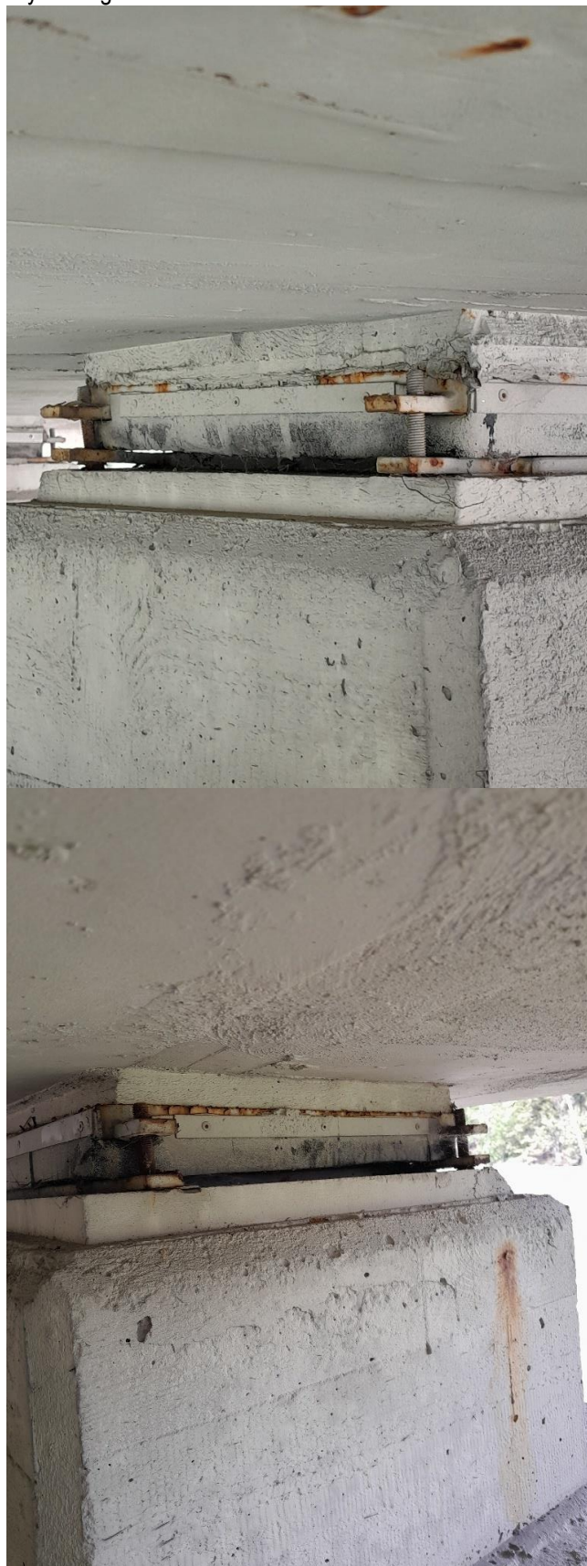
fot. 39. Filar w osi C – korozja blach łożysk, uszkodzenie podlewki, korozja zbrojenia płyty pomostu i ciosu podłożyskowego
