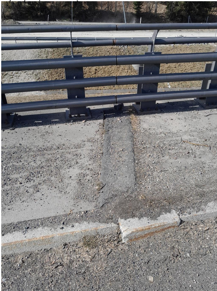
fot. 56. Krawężnik – Uszkodzenie krawężnika, nanos na jezdni i chodniku, uszkodzenia połączenia dylatacji z kapa chodnikową
