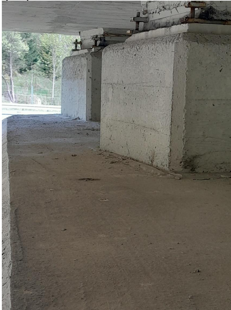
fot. 38. Filar w osi B – korozja blach łożysk, uszkodzenie podlewki, korozja zbrojenia ciosów podłożyskowych
