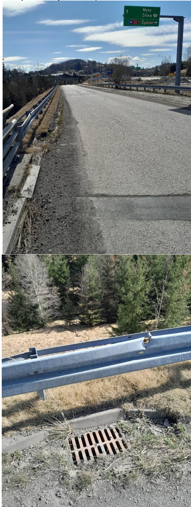
fot. 61. Bariery na dojazdach, wpust odwodnieniowy – deformacja oraz zniszczenie od strony miejscowości Myto, zanieczyszczenie wpustu
