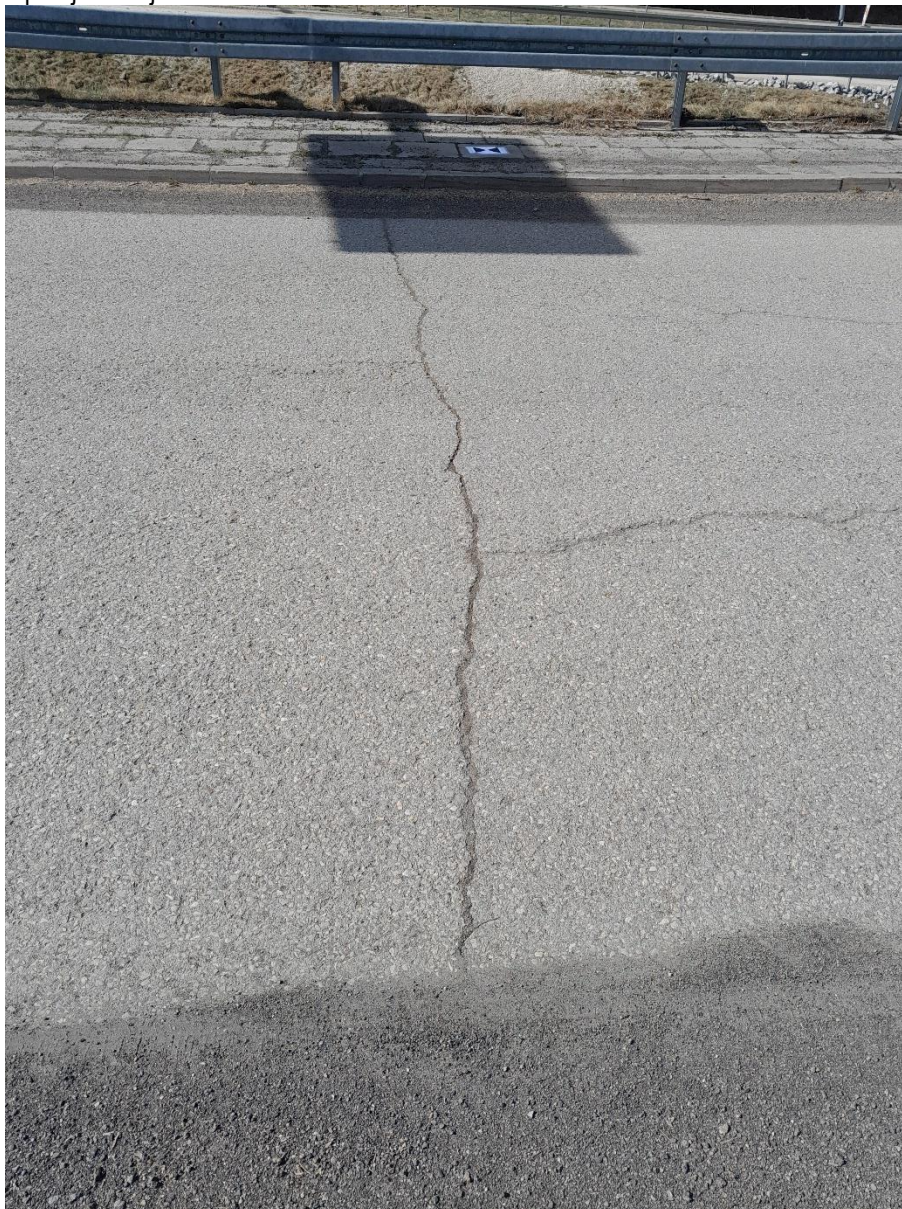
fot. 49. Nawierzchnia – na dojeździe od strony miejscowości Myto, spękanie w miejscu zakończenia płyty przejściowej
