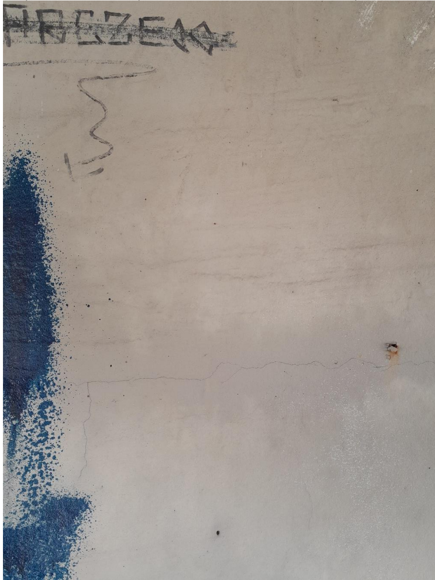
fot. 27. Przyciółek w osi G – zarysowanie poziome i pionowe korpusu przyciółka- 2
