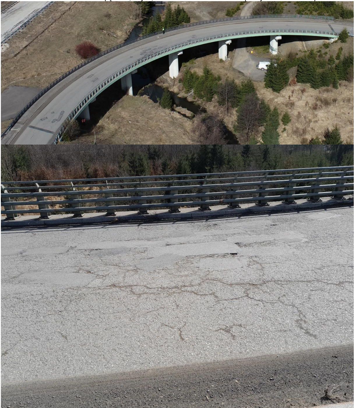
fot. 50. Nawierzchnia – spękania, ubytki, skolinowanie oraz lokalne naprawy nawierzchni na pomoście
