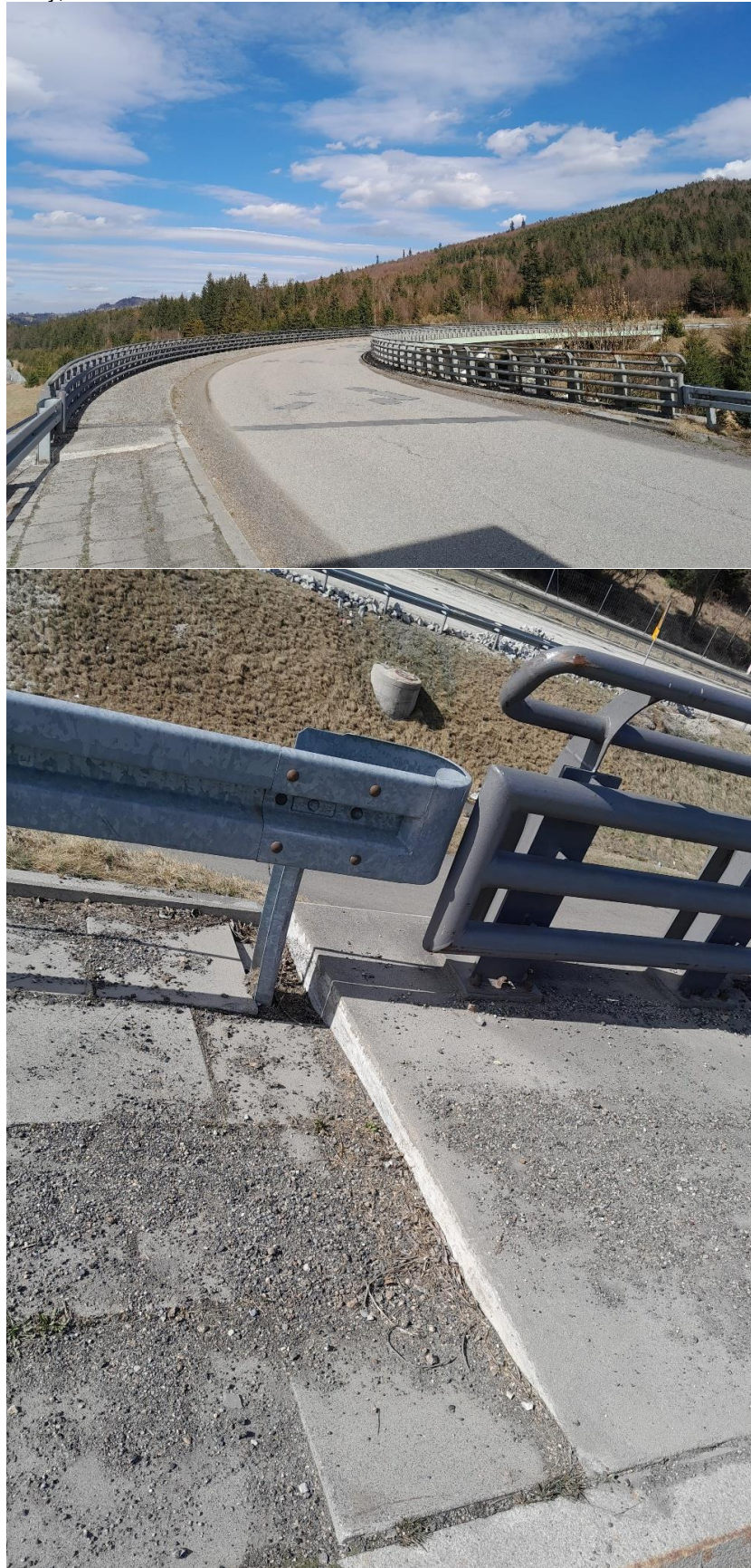
fot. 57. Uskok pomiędzy chodnikiem, na obiekcie i na dojeździe od strony miejscowości Myto, nanos wzdłuż krawędzi jezdni, uszkodzenia nawierzchni, lokalne naprawy nawierzchni, brak ciągłości bariery,
