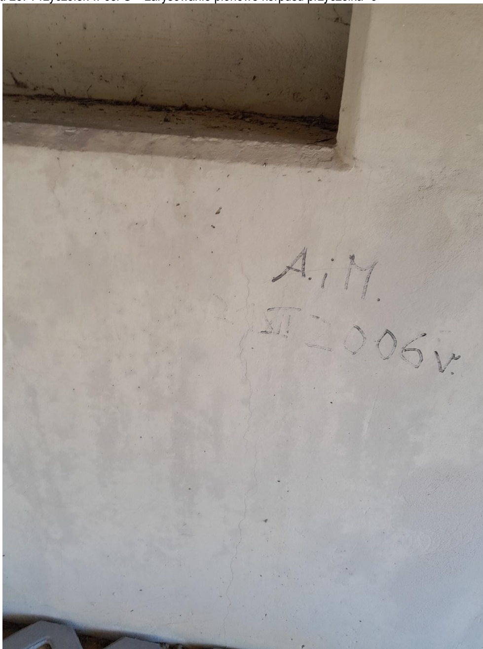
fot. 28. Przyczółek w osi G – zarysowanie pionowe korpusu przyczółka- 3
