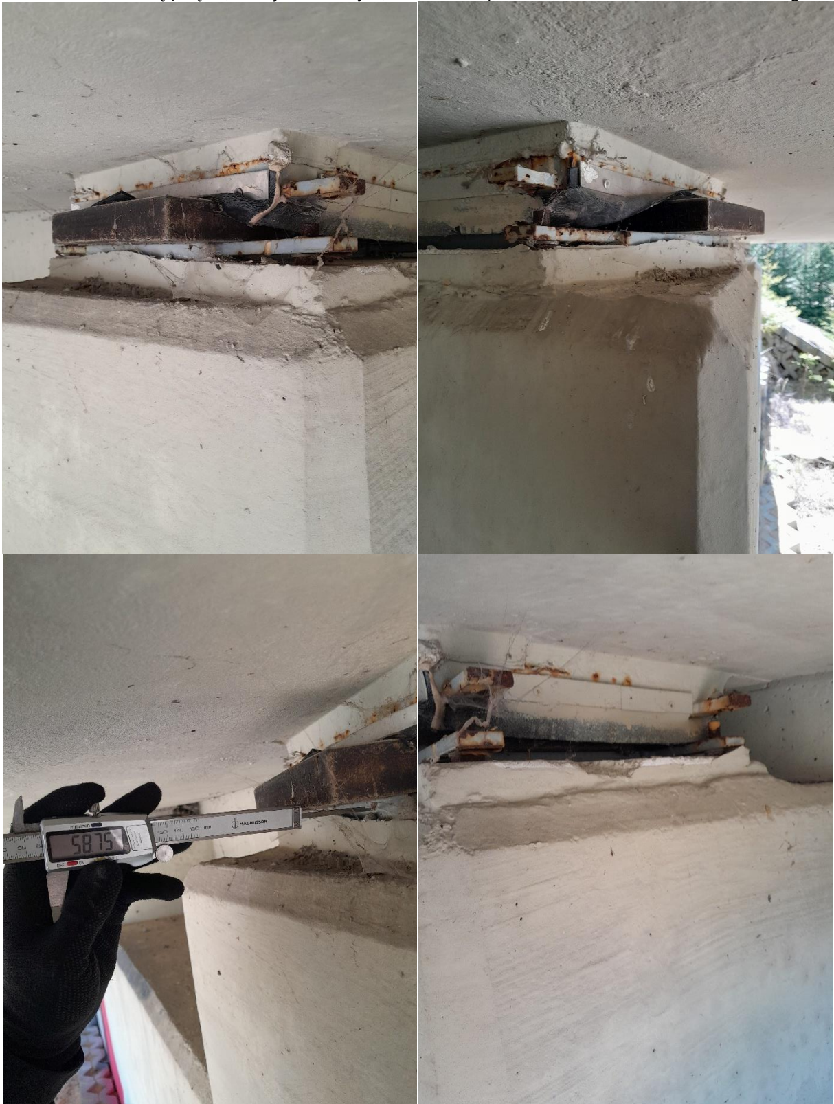
fot. 44. Przyczółek w osi G, łożysko wewnętrzne przedskrajne– Wysunięcie bloków elastomerowych w stronę przęsła, korozja blach łożysk, uszkodzenie podlewki, uszkodzenie fartucha ochronnego
