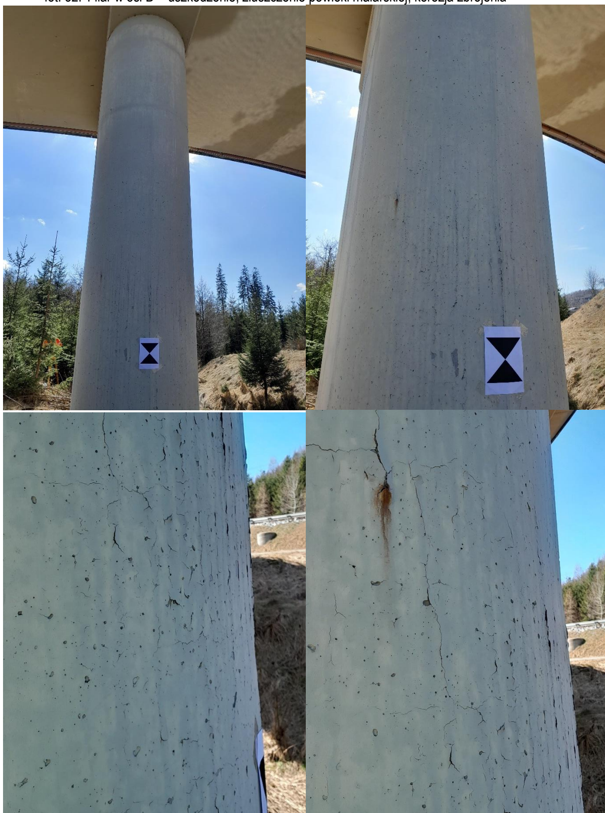
fot. 32. Filar w osi D – uszkodzenie, złuszczenie powłoki malarskiej, korozja zbrojenia
