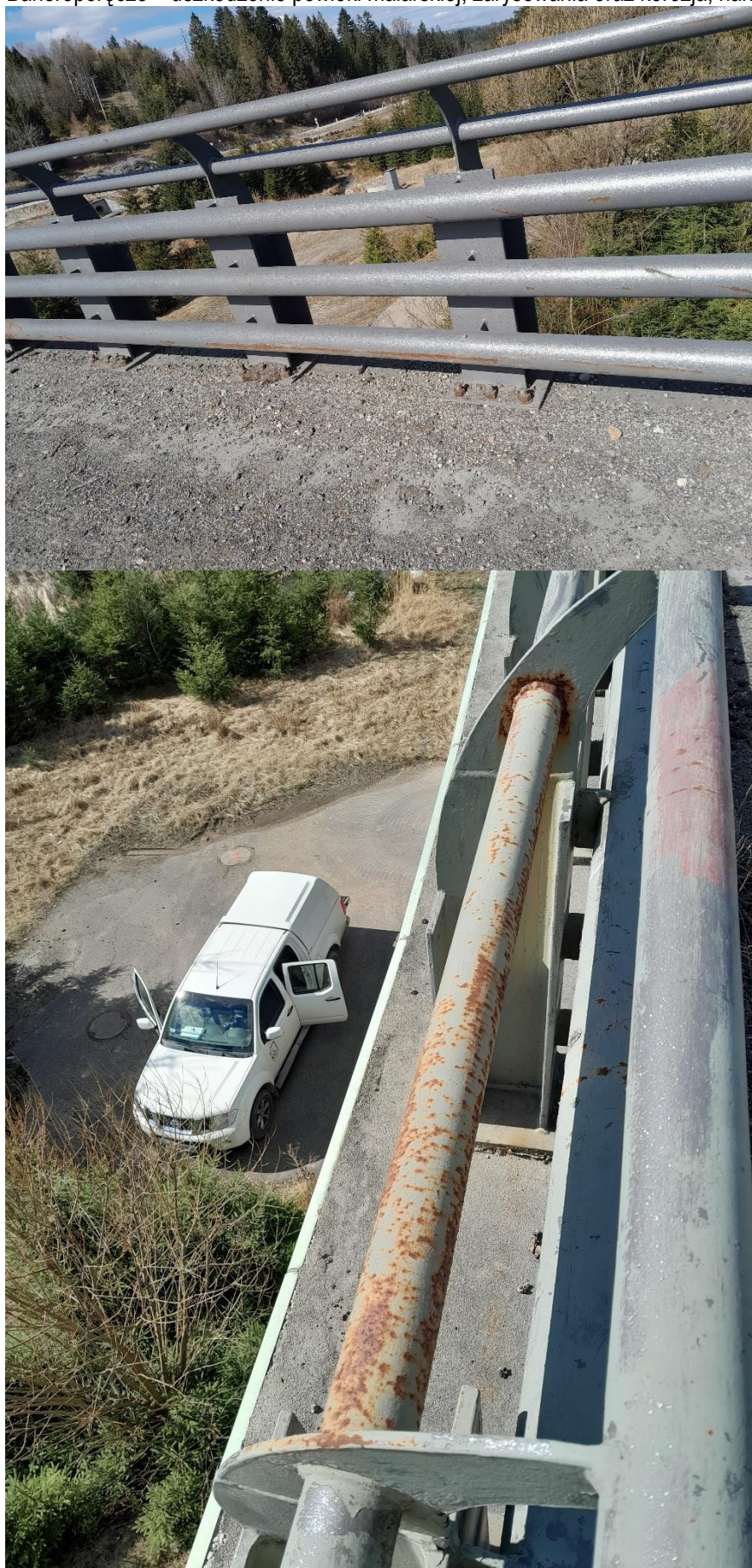
fot. 58. Barieroporecze – uszkodzenie powłoki malarskiej, zarysowania oraz korozja, nanos na chodniku
