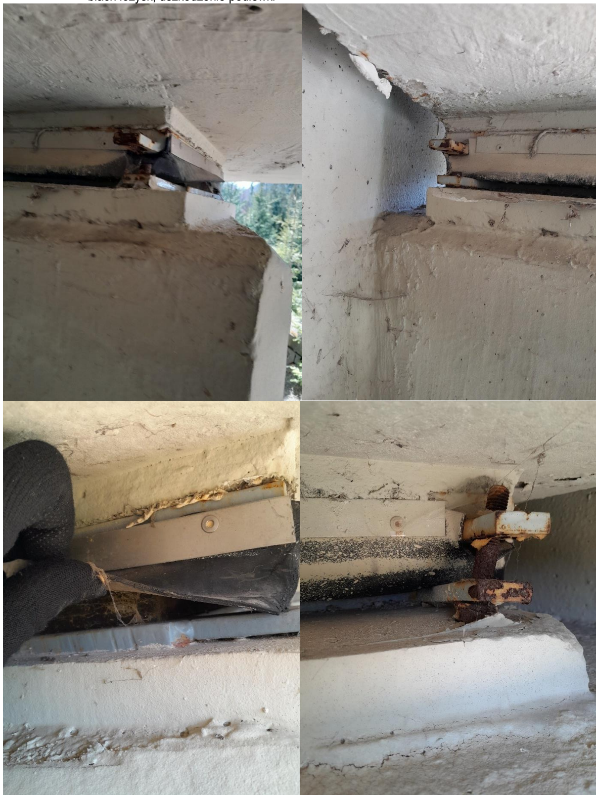
fot. 43. Przyczółek w osi G, łożysko wewnętrzne skrajne– Wysunięcie bloków elastomerowych, korozja blach łożysk, uszkodzenie podlewki
