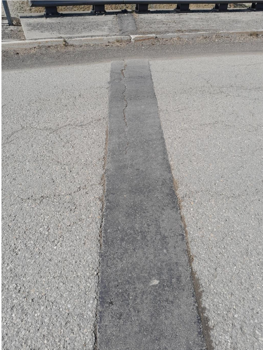
fot. 48. Nawierzchnia – dylatacja w osi A – spękania nawierzchni, spekania dylatacji, nanos przy krawężniku,
