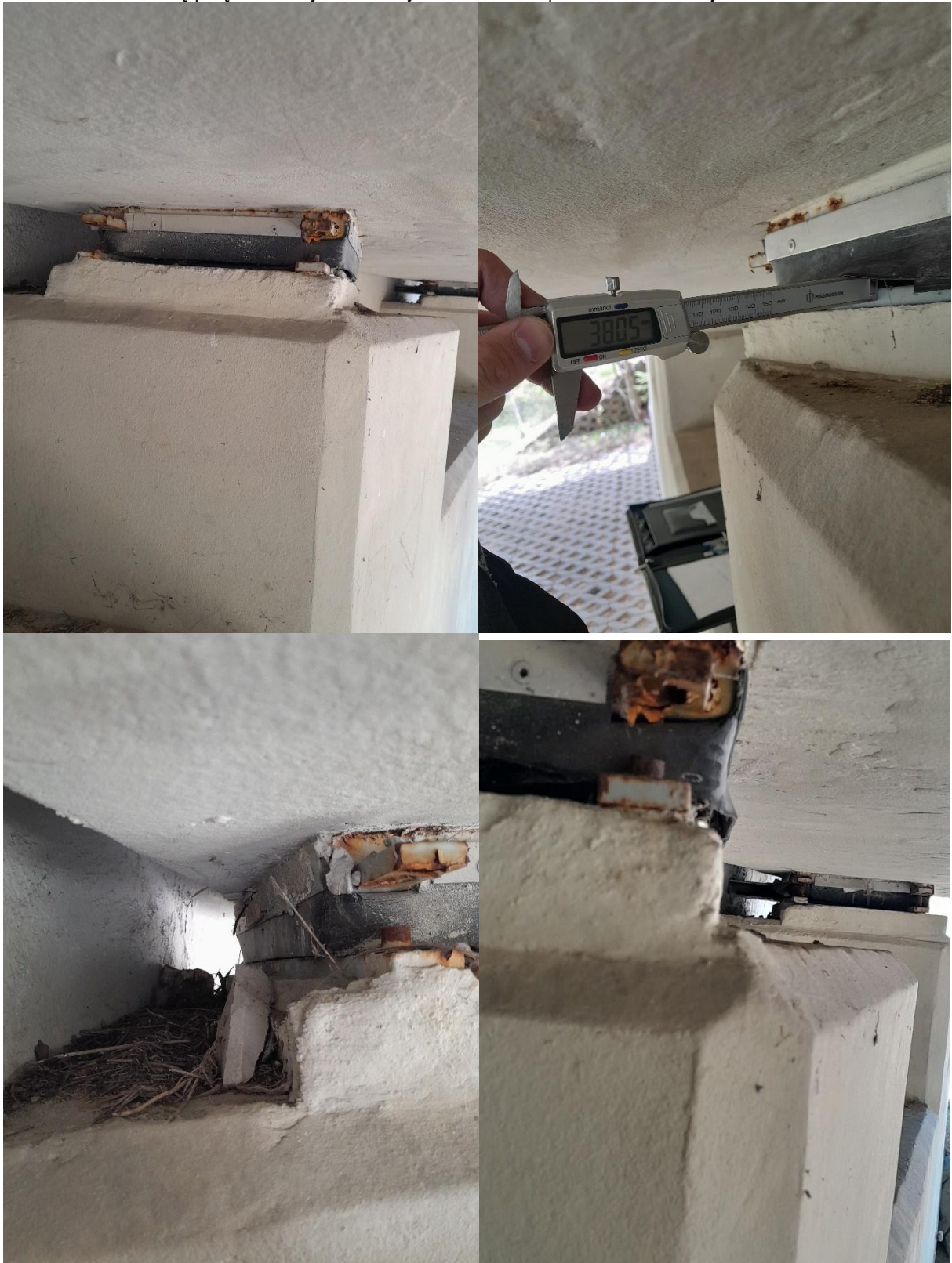
fot. 36. Przyciółek w osi A, łożysko zewnętrzne przedskrajne– Wysunięcie bloków elastomerowych w stronę przęsła, korozja blach łożysk, zniszczenie podlewki żelbetowej
