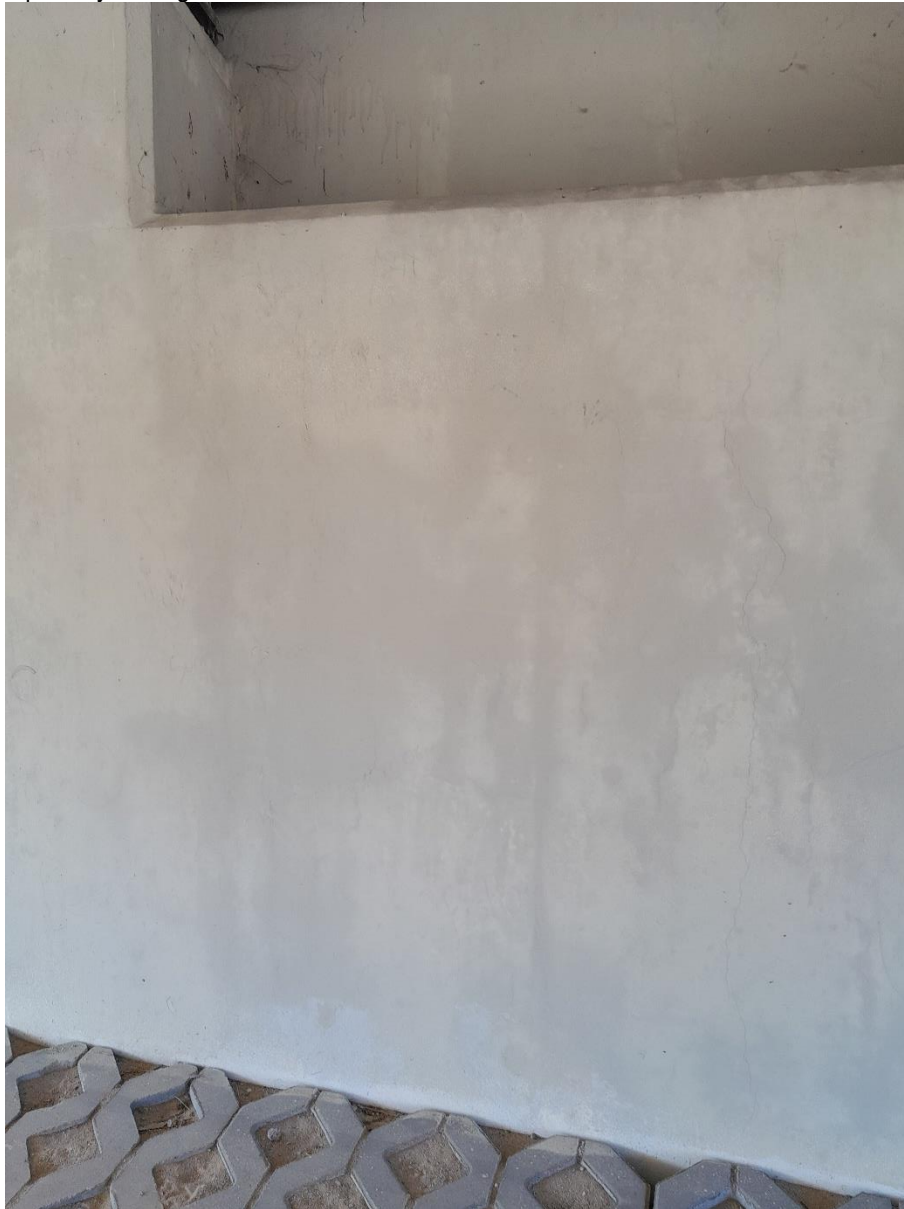
fot. 21. Przyczółek w osi A – zarysowanie pionowe korpusu przyczółka, zarysowanie poziome ciosu podłożyskowego- 1
