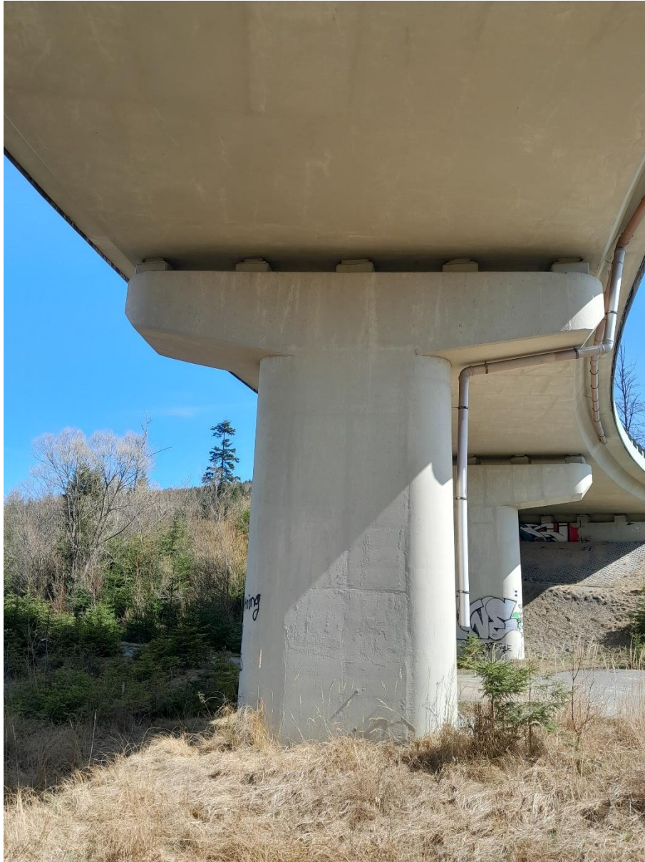
fot. 15. Widok filara w osi E od strony miejscowości Myto. Brak rury spustowej przy podstawie filara. Zanieczyszczenie filara graffiti.
