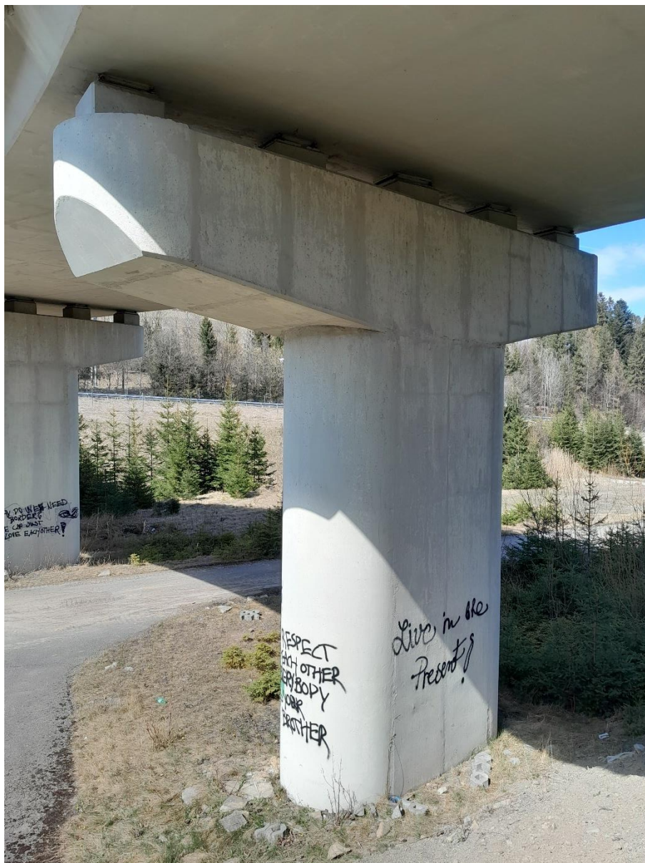
fot. 18. Widok filara w osi G od strony miejscowości Zwardoń. Zanieczyszczenie filara graffiti.
