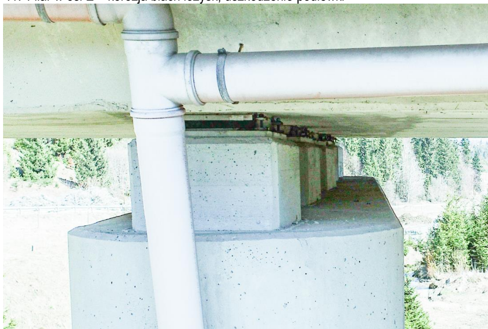
fot. 41. Filar w osi E – korozja blach łożysk, uszkodzenie podlewki
