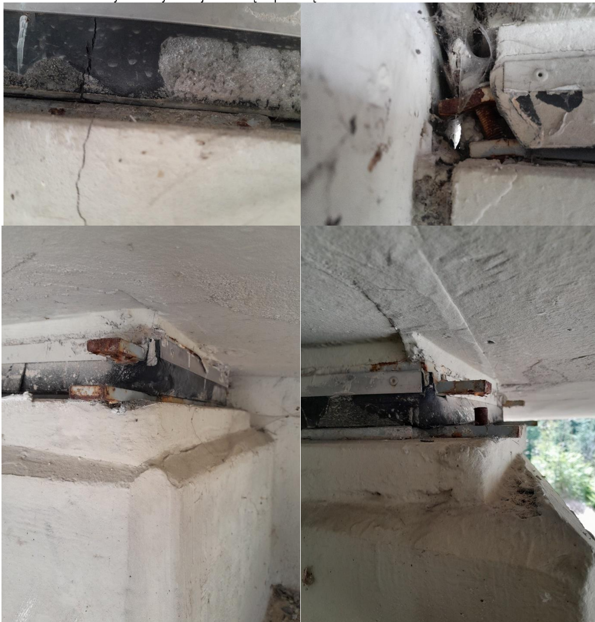
fot. 45. Przyciółek w osi G, łożysko środkowe– korozja blach łożysk, uszkodzenie podlewki, oparcie blachy nad łożyskowej o ściankę zapleczną
