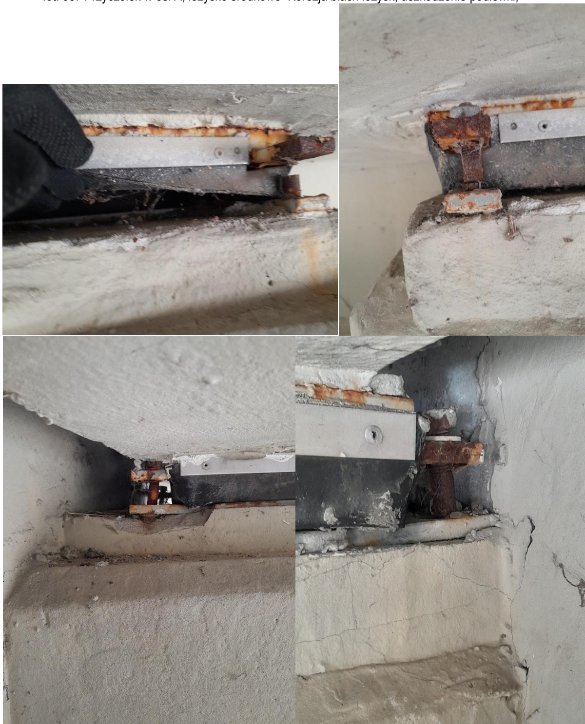
fot. 35. Przyczółek w osi A, łożysko środkowe–Korozja blach łożysk, uszkodzenie podlewki,
