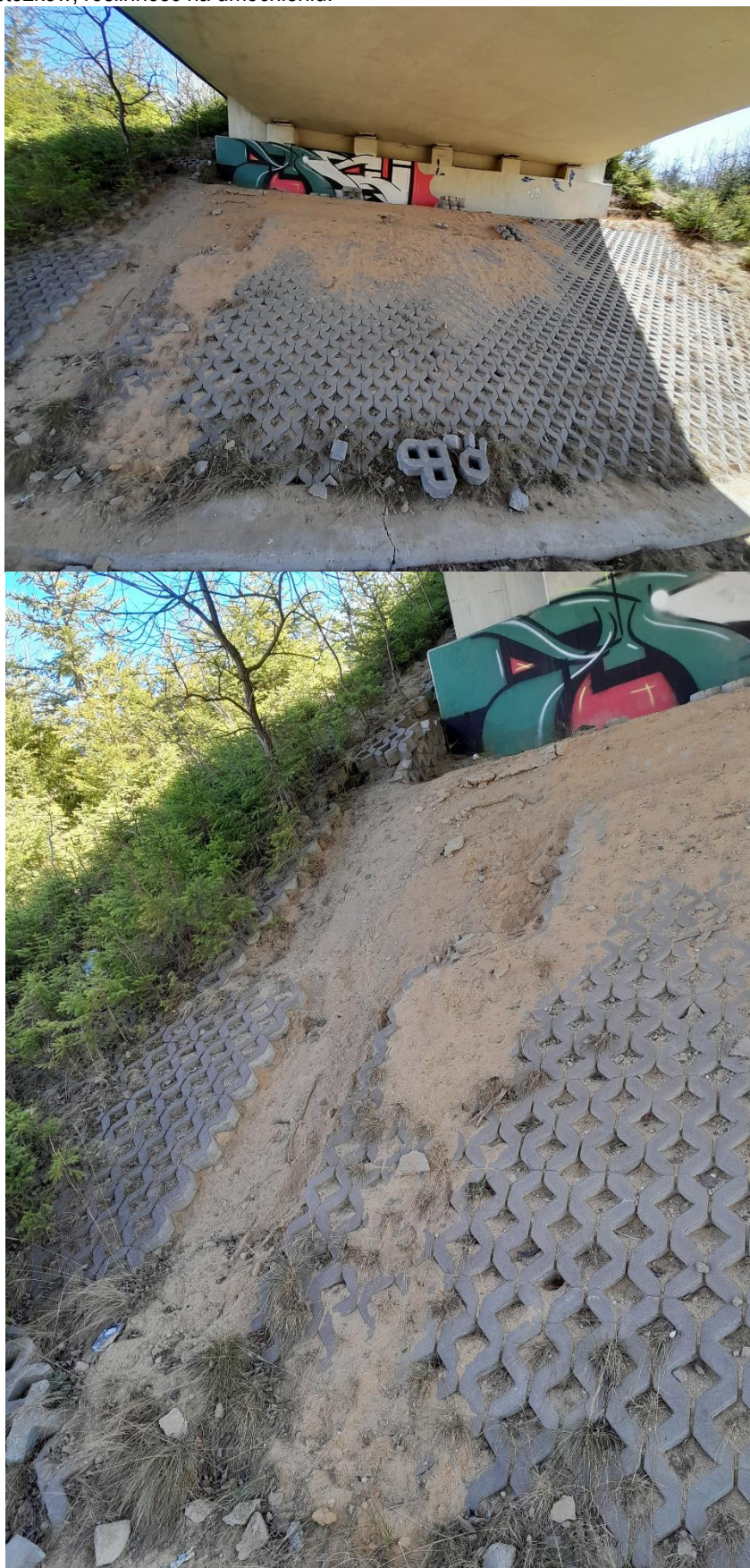
fot. 24. Przyczółek w osi G – zanieczyszczenie powierzchni betonowej graffiti, ubytki umocnienia stożków, roślinność na umocnieniu.
